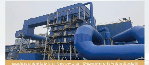
中高温脱硫脱硝催化剂及成套技术应用于鞍钢集团焦化烟气脱硫脱硝装置
